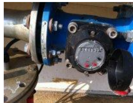
Zähler am Bohrlochausgang
