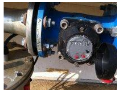
Compteur à la sortie du forage
