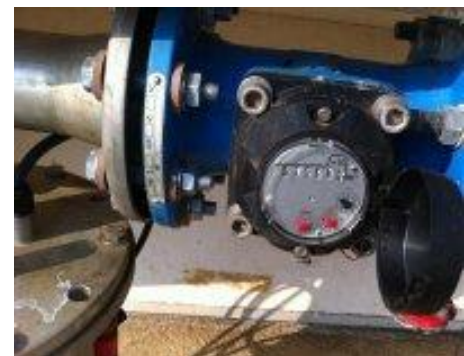
Zähler am Bohrlochausgang
